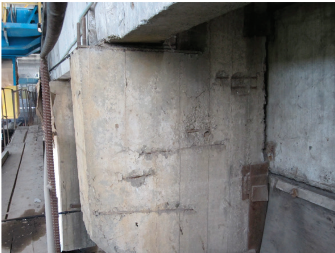
Рис. 4. Оголение рабочей арматуры в консоли колонны
