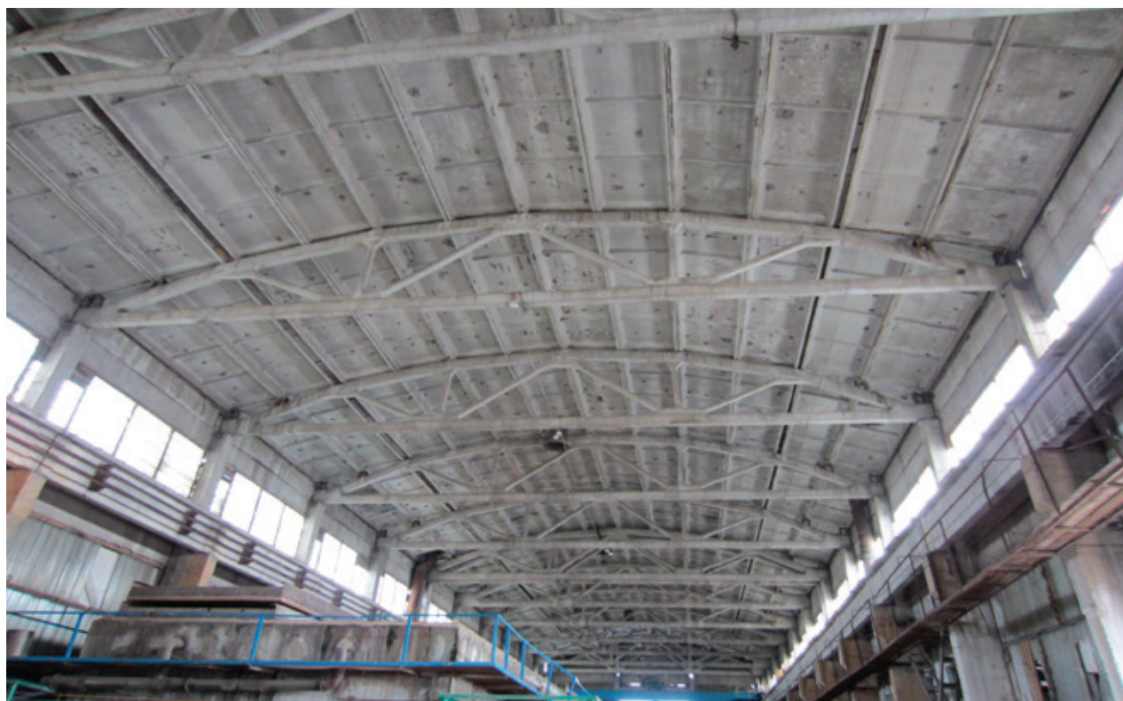
Рис. 2. Следы коррозии стропильных конструкций
