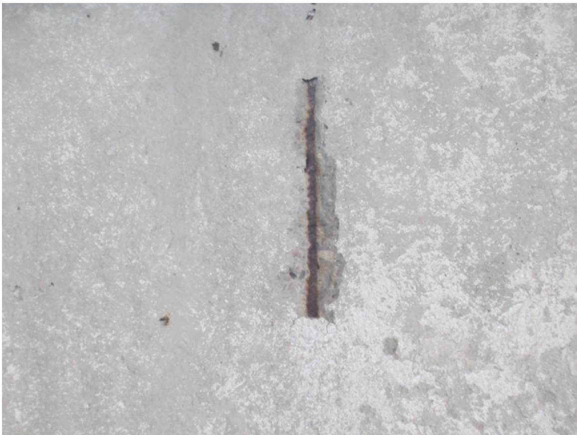
Рис. 3. Оголение рабочей арматуры
