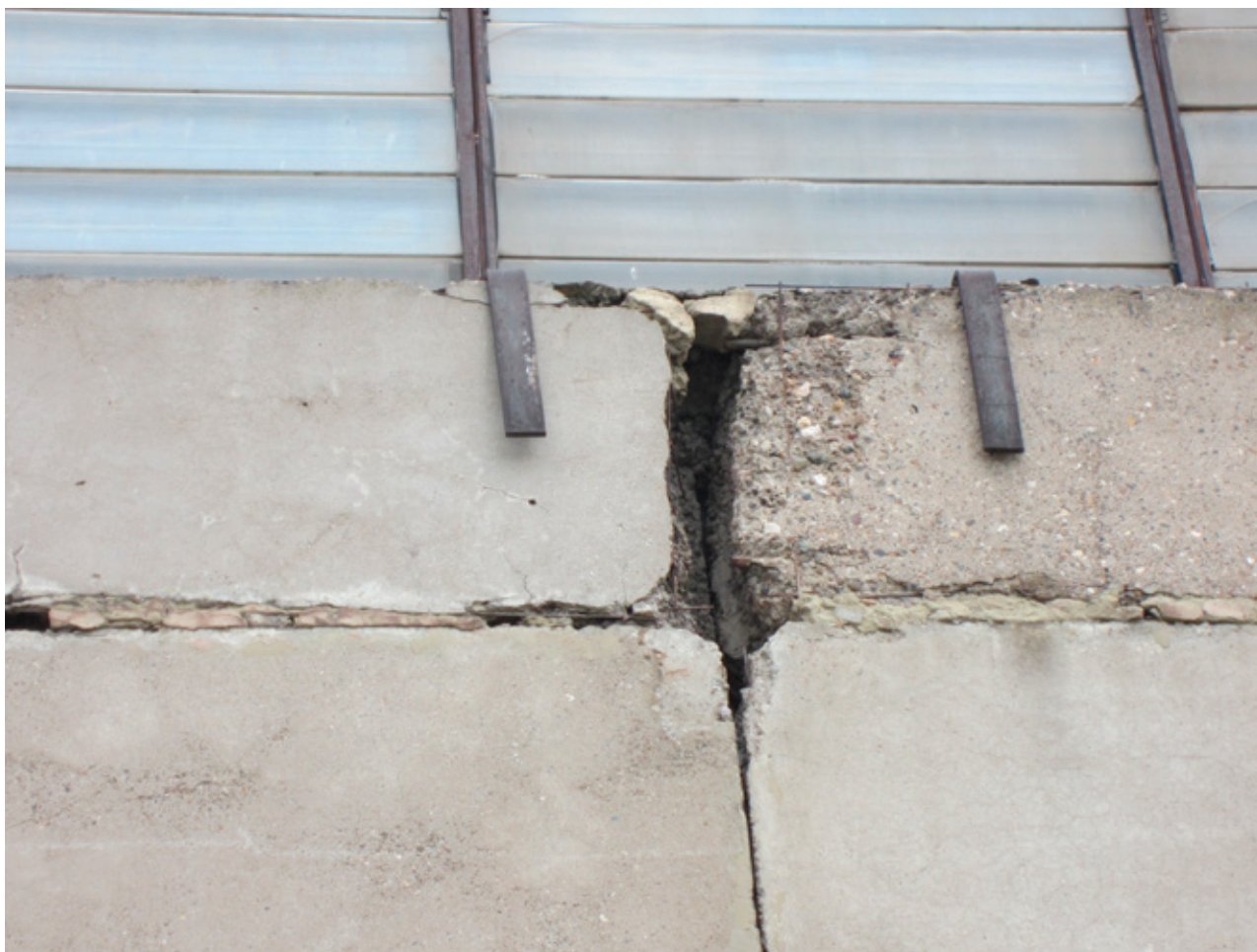
Рис. 1. Разрушение наружных ж/б панелей
