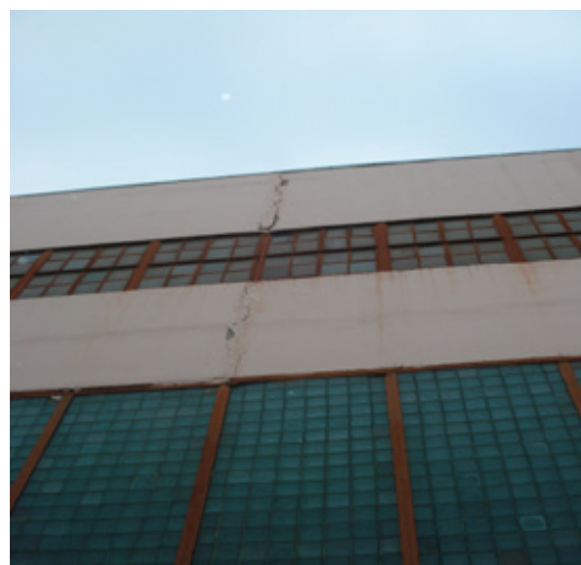
Рис. 4. Трещина проходящая по деформационному шву
