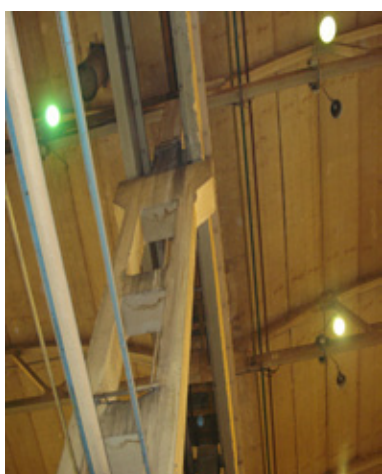
Рис. 3. Частичные сколы подкрановой балки
