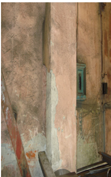
Рис. 1. Скол защитного слоя колонн
