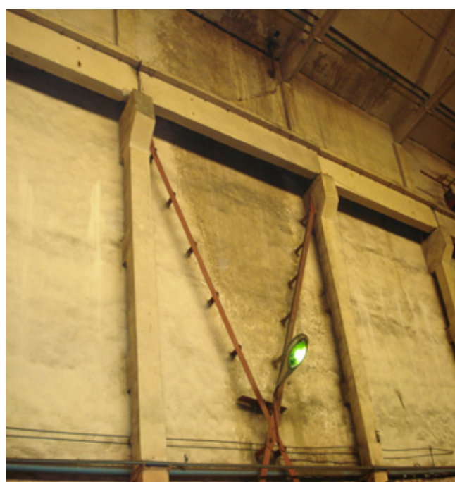
Рис. 2. Замачивание ограждающих конструкций
