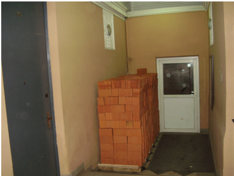
Рис. 1. Климентовский пер. д. 6 в Москве (построен в 1912 г.) признан объектом культурного наследия. Дополнительная нагрузка на старые деревянные перекрытия недопустима и может рано или поздно вызвать их обрушение, особенно, если по той или иной причине «тряхнет», чего в наше время исключать нельзя. Новые перегородки из блоков вместо старых из дранки положены в квартирах № 85, 88 и частично в кв. № 79. Сейчас работы идут в кв. 90. ДЕЗ Замоскворечье не принимает мер и отказывается составлять акты о повреждениях соседних квартир.
