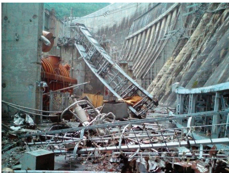
Рис. 4. Разрушенная Саяно-Шушанская ГЭС
