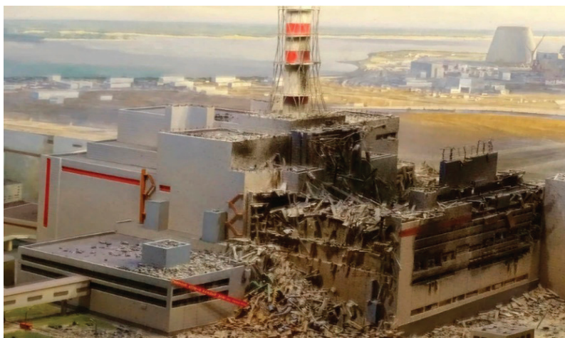
Рис. 2. Разрушенный четвертый энергоблок
