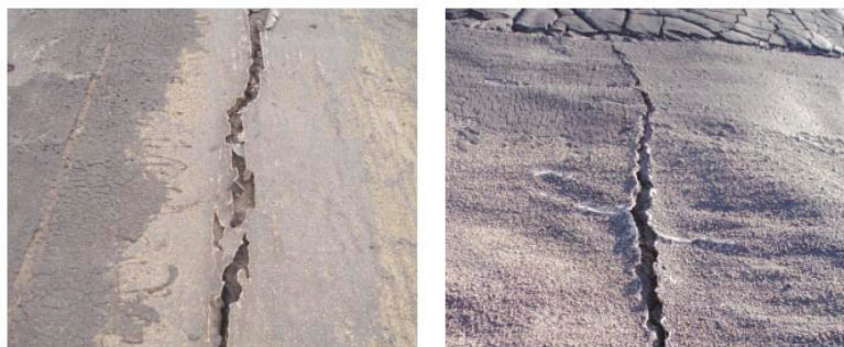
Рис. 3. Пример дефекта — трещины в кровельном покрытии из наплавляемого рулонного материала
