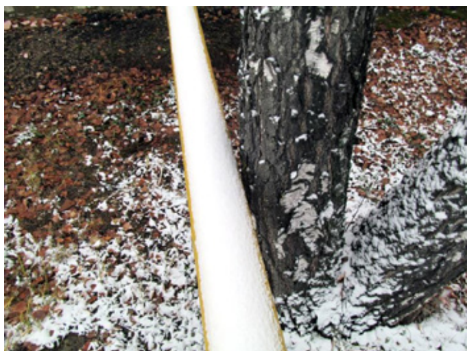
Рис. 2. Не соблюдается расстояние от дерева до надземного участка газопровода
