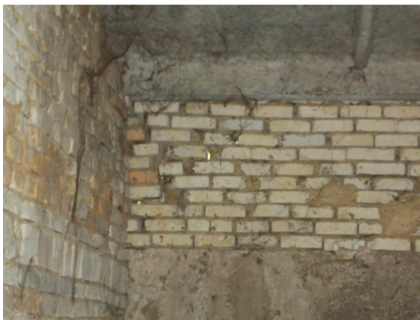
Рис. 2. Разрушение кирпичной кладки склада по хранению взрывоопасных веществ
