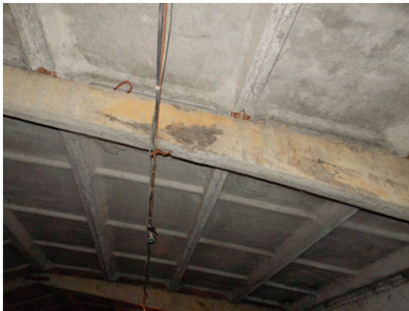
Рис. 1. Разрушение железобетонной балки
